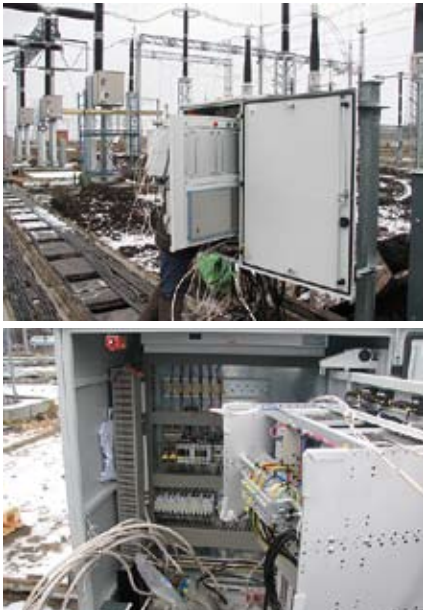
Рис. 6. Шкафы наружной установки с полевыми терминалами Siemens BMD613, используемыми для сбора дискретной информации с ОРУ 500 кВ и 110 кВ ПС «Воронежская» и для управления разъединителями
