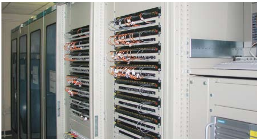
Рис. 7 (вверху). Коммутаторы Ruggedcom на ПС 500 кВ «Воронежская»
