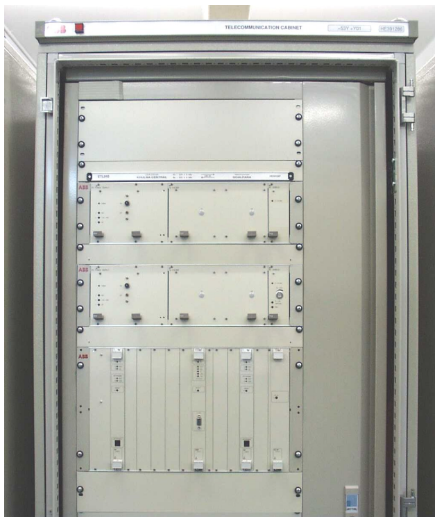
Рис. 7-4 Внешний вид аппаратуры ETL582 размещенной в шкафу E40A.R.
